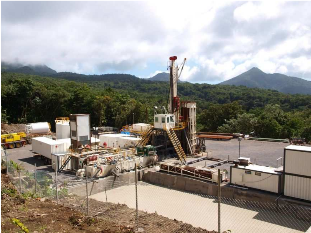
Figure 2. Photo d'un site de forage d'exploration dans le Commonwealth de la Dominique. Au premier plan, le bassin (bourbier) destiné à stocker les boues de forage. Photo : Sigurdur Sveinn Jonsson.
